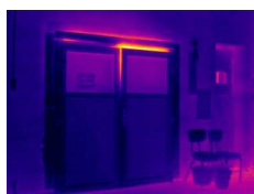
Défaut d'étanchéité d'une porte (extérieur)
